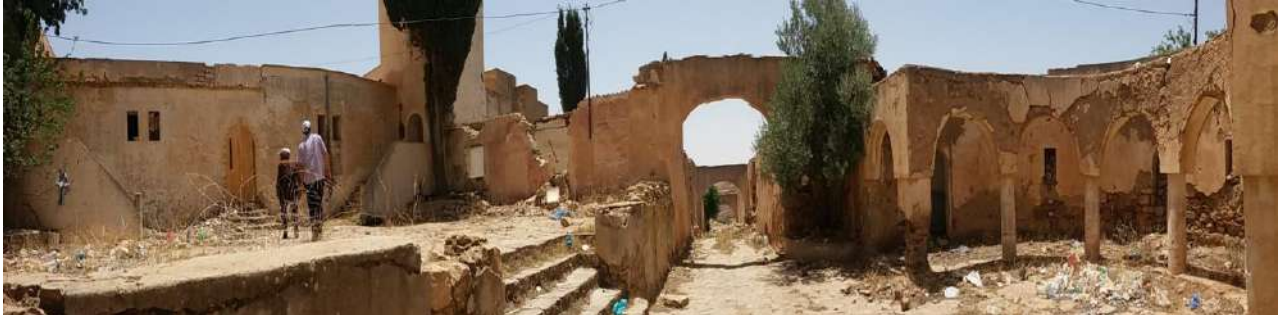
Figure 27 : Photo montrant l'état dégradé de la cité ouvrière de Sidi Boubker
